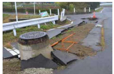
液状化によるマンホールの抜け上がり (山形県蔵王町円田)
