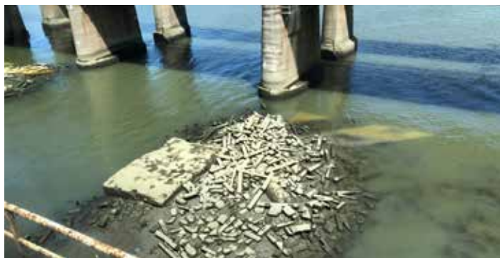
▲今も相模川に残る、大正関東地震で倒壊した馬入橋橋梁の残骸。
