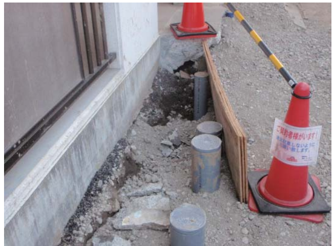
地盤沈下とコンクリートの破壊
