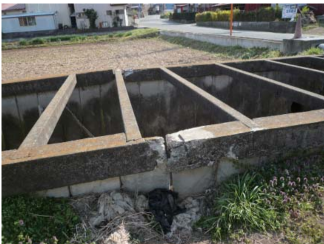
用水路の亀裂
